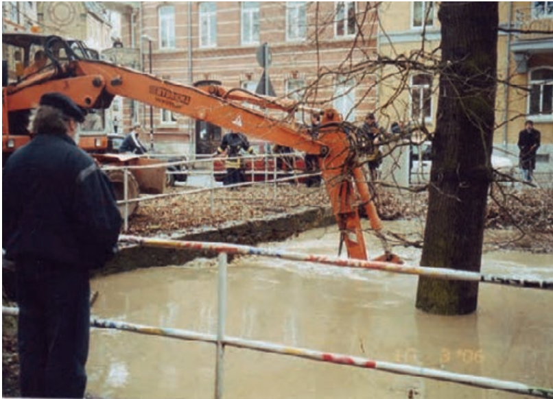
Abbildung 11.3: Räumung am Leutra-Rechen 2006 (Quelle: Stadt Jena)
