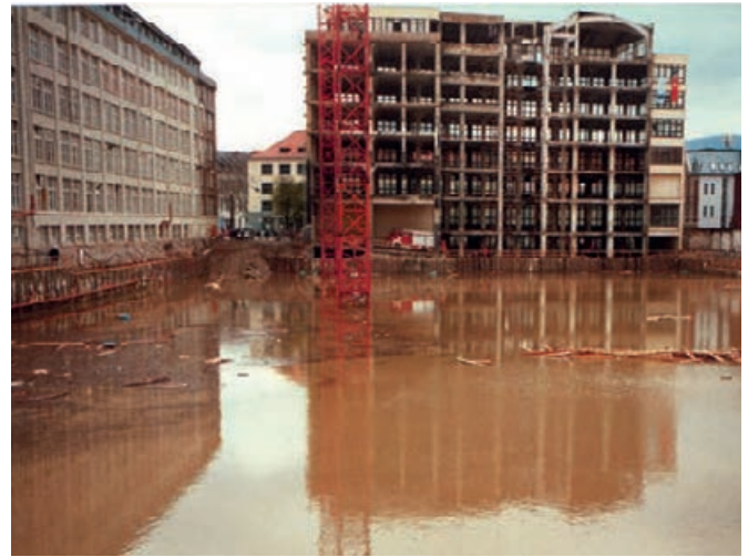
Abbildung 5.5: Überflutete Baugrube der Goethe-Galerie nach einem Hochwasserereignis an der Leutra im April 1994 (Quelle: Stadt Jena)
